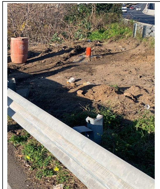
Pozzetti protezione Tubo DH
